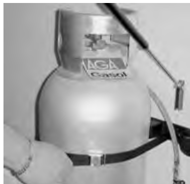
Kontroller at gassflasken er ordentlig festet.
