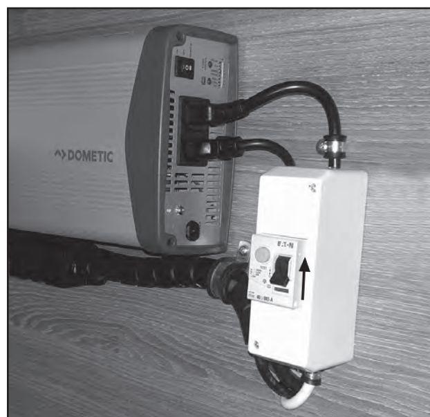
Ein Erdschluss-Schalter ist am Spannungswandler montiert.
