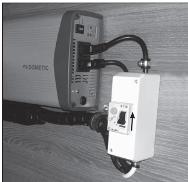
En jordfeilbryter er montert ved inverteren.
