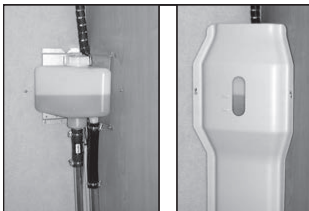
Expansievat en afdekplaat met inspectieopening.
