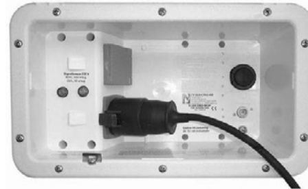
Außenseite des Schaltkastens
