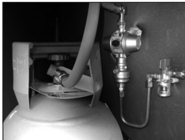
Gassflasken i gasskassen.
