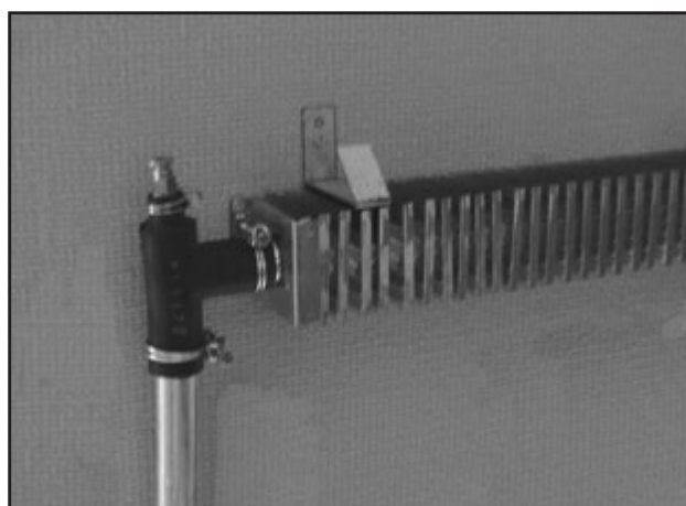
Lämpöpatteri ja letkuliitos ilmausruuveineen.
