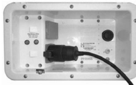
Außenseite des Schaltkastens
