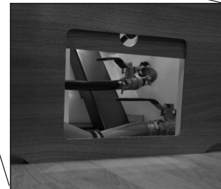
Tuorevesisäiliön venttiilit: ylitäyttösuoja 45 litraa ja tyhjennysventtiili tuorevesisäiliön tyhjennykseen.
