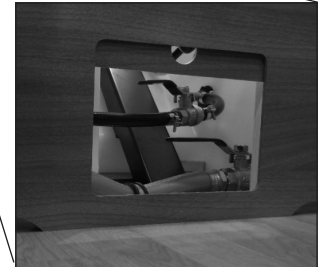
Tuorevesisäiliön venttiilit: ylitäyttösuoja 45 litraa ja tyhjennysventtiili tuorevesisäiliön tyhjenykseen.
