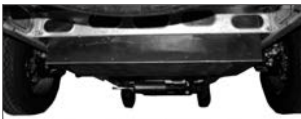
Gråvattentanken monterad mellan husbilens bakhjul.
