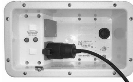
Außenseite des Schaltkastens
