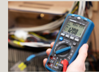
SÄHKÖJÄRJESTELMÄ. Sähköjärjestelmät ja muut tärkeät toiminnot tarkastetaan, ennen kuin matkailuautot toimitetaan tehtaalta.
