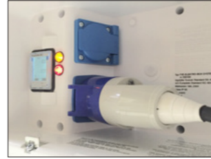
Kilowattmeter in elektriciteitskast
