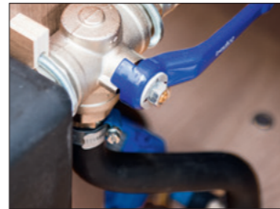
Viemäri; harmaavesisäiliön ohikytentä (vakiovaruste Imperialissa)
