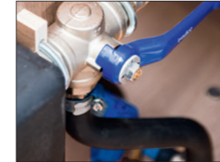
Viemäri; harmaa vesisäiliön ohikytkentä
