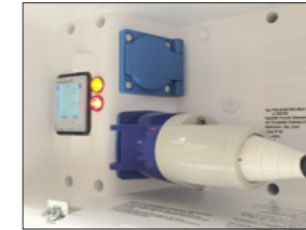
Stromzähler im Schaltkasten
