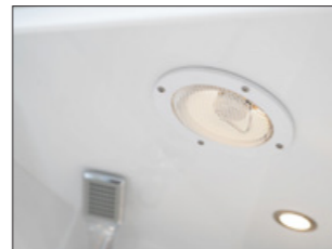
Lüfter in Duschkabine (TDL)
