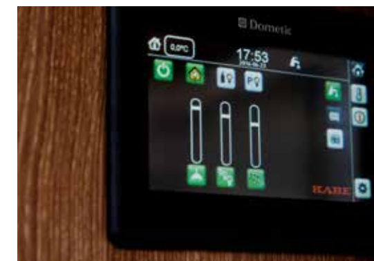
På startsidene vises alle knapper for belysning og digitale skyvebrytere for dimmer. Her ser du også temperatur, både ute og inne, og klokke.
