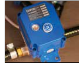
Elektrisk tømning av avløp
