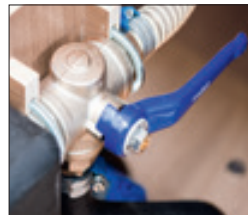
Viemäri; harmaavesisäiliön ohikykentä
