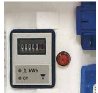
Stromzähler Fest im Schaltkasten montiert. Beleuchtung (X0255) im Schaltkasten.
