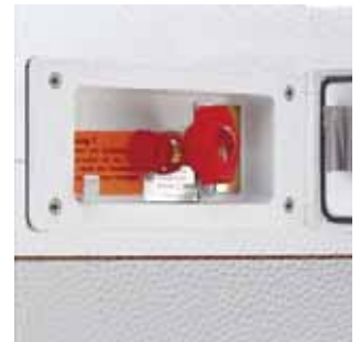
Gasanschluss außen Für Gasgrill im Freien.
